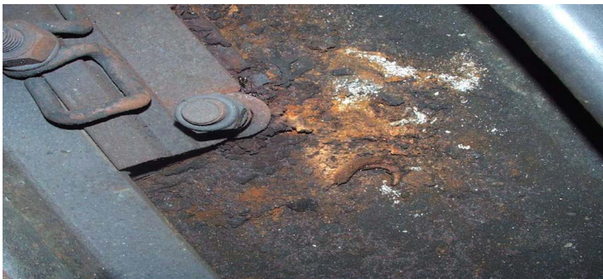
Obr. 3. Pohľad na koľajnicu, pružinu s maticou, rebrovú podložku a samotesniacu bezpečnostnú maticu vo fáze pokročilej korózie. Na vyleptanom betóne leží rozpadnutý zvyšok prstencovej plastovej podložky pôvodne umiestnenej na kotviacej skrutke. Mäkká hmota vznikajúca depolymerizáciou polyuretánovej podložky je vytlačaná spod rebrovej podložky.
